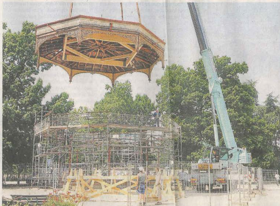
Le toit du kiosque à musique a été soulevé puis posé sur une charpente en bois. Il sera démonté pour être rénové.
